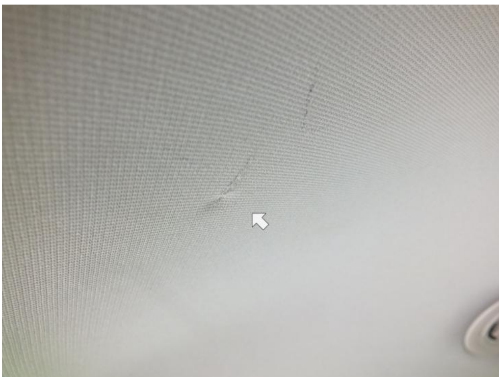
Fot. 38. PODSUFITKA - ROZERWANIE
